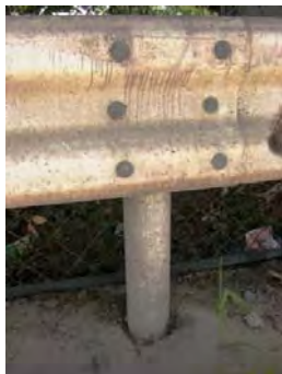
⑤西羽束師川支川五間掘流域ほぼ最深地点 ガードレールは冠水したと思われる（長岡京市勝竜寺）
