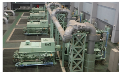
新八幡排水機場のポンプ室
