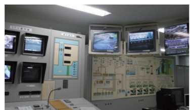
情報をリアルタイムに集中管理する操作室
