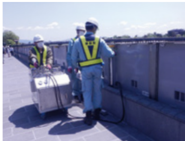
京都市による可動式止水壁の点検
